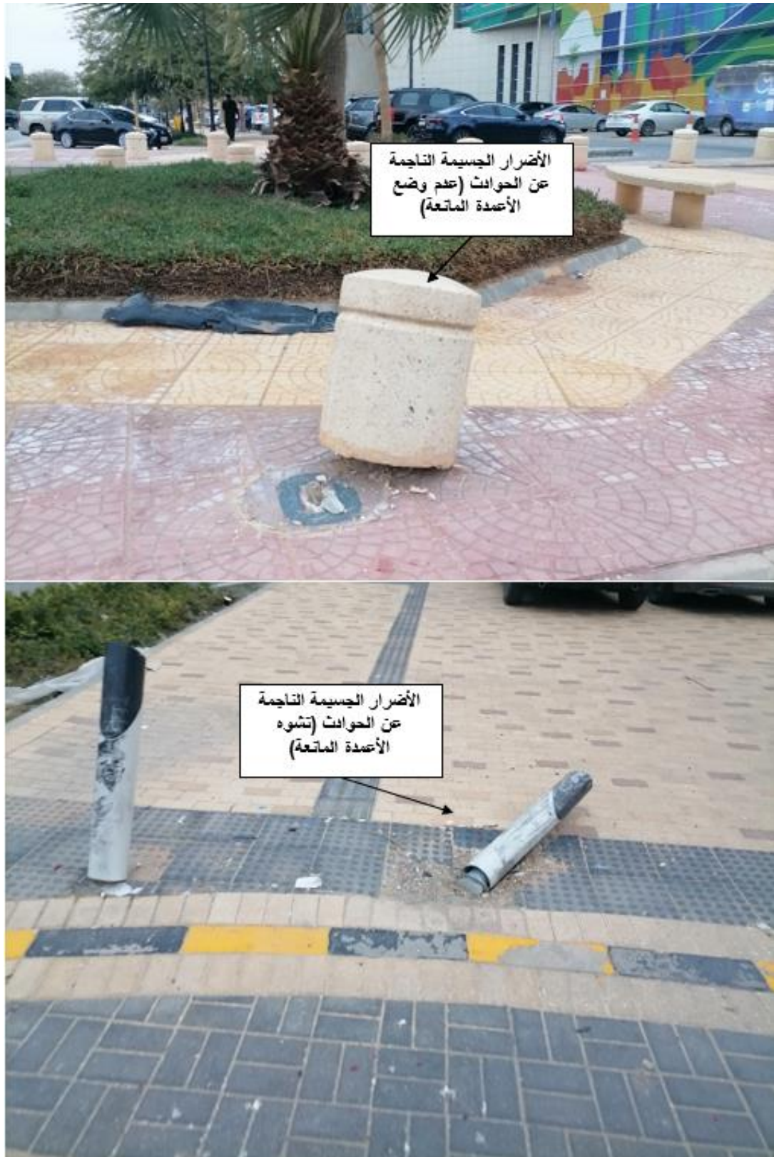
الشكل (٣-١١) عيوب الحواجز المانعة لوقوف المركبات.
