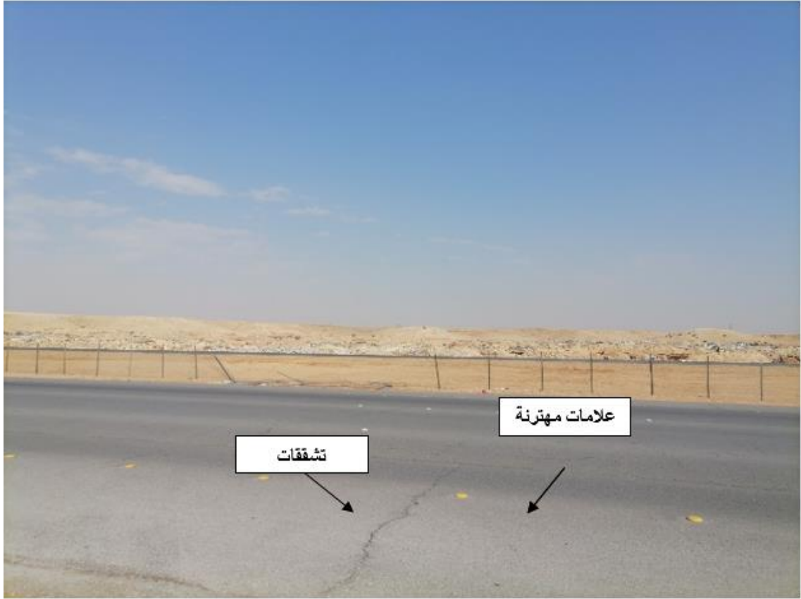
الشكل (١-٣) عيوب أكتاف الطريق المُعبدة.
