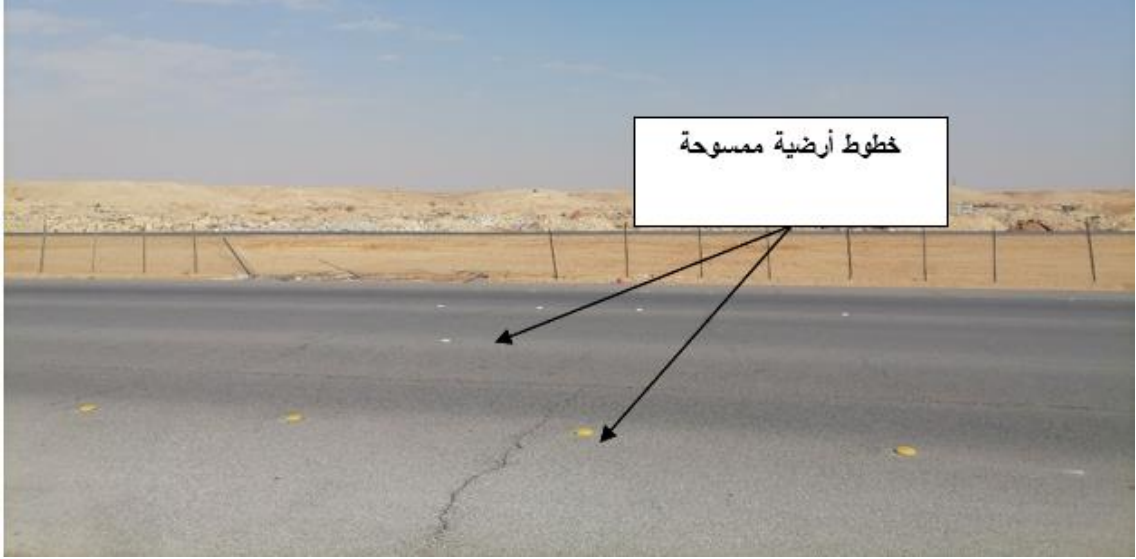
الشكل (٢٣-٣) عيوب علامات الرصف.
