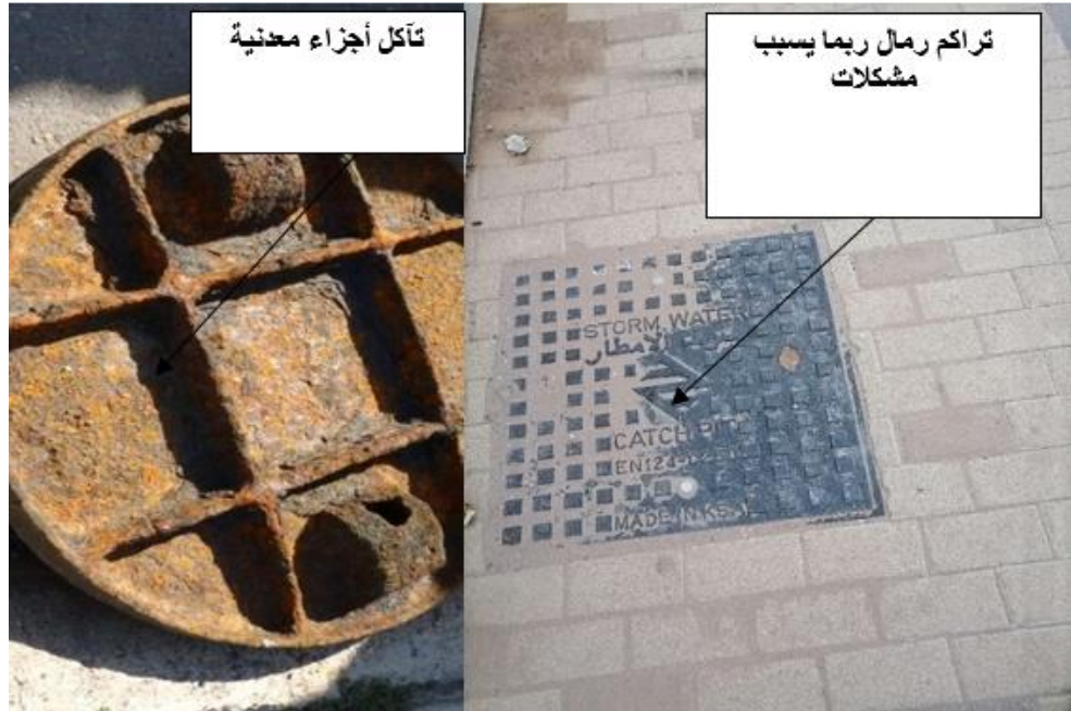
الشكل (١٥-٣) عيوب غرف التفتيش والمداخل والأغطية.
