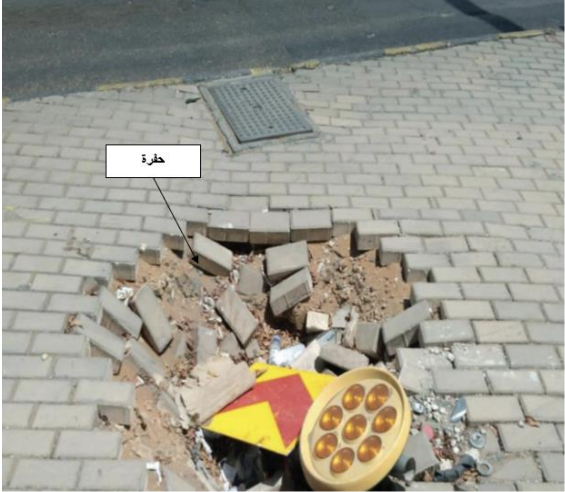
الشكل (٨-٣) عيوب أرصفة المشاة.
