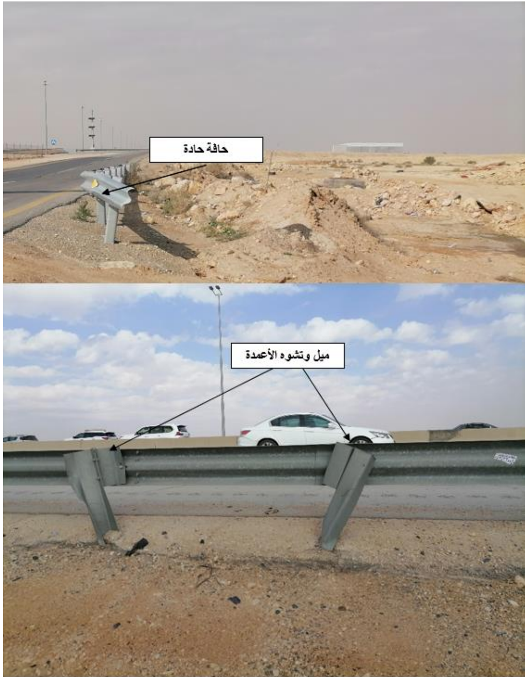
الشكل (٦-٣) عيوب حواجز الحماية.
