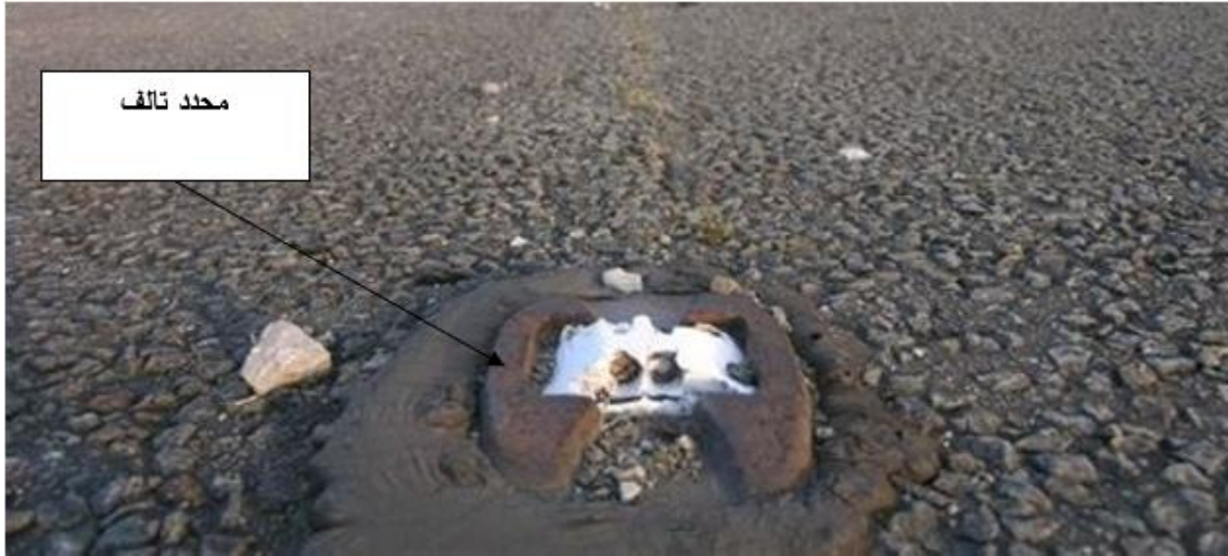
الشكل (٣-٢٤) عيوب محددات الرصف القائمة.
