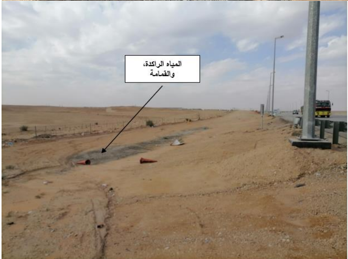
الشكل (٣-٣) عيوب الجسر الترابي ومناطق القطع.
