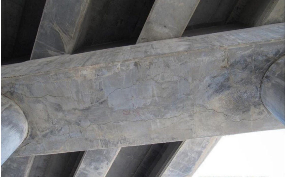
الشكل (٣-٤) الشقوق الملحوظة في أسفل الكمرات الخرسانية.
