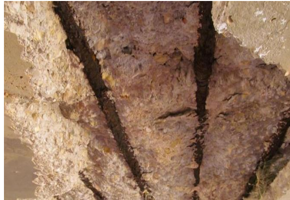
الشكل (٤-٤) الشقوق الملحوظة في أسفل الكمرات الخرسانية
