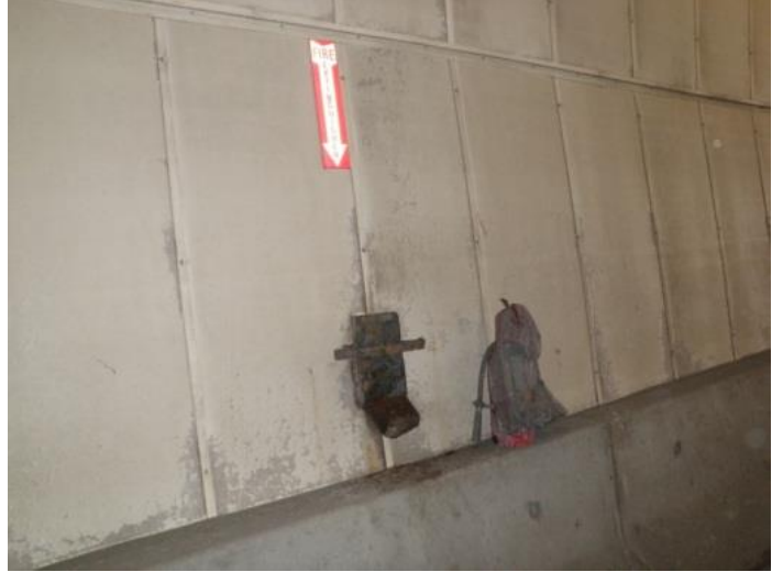
الشكل (٧-٣٩) طفاية حريق مفقودة.
