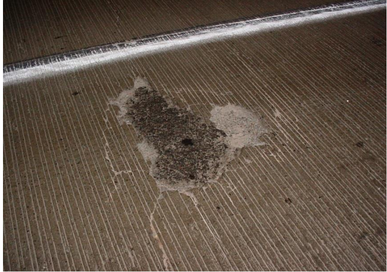
الشكل (٧-٣٤) حفرة أرضية بها تشقق في طبقة الرصف السطحية الخرسانية.
