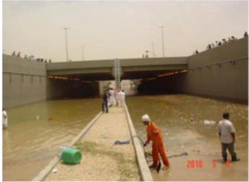
الشكل (٢-٨) فشل تصريف مياه الأمطار.
