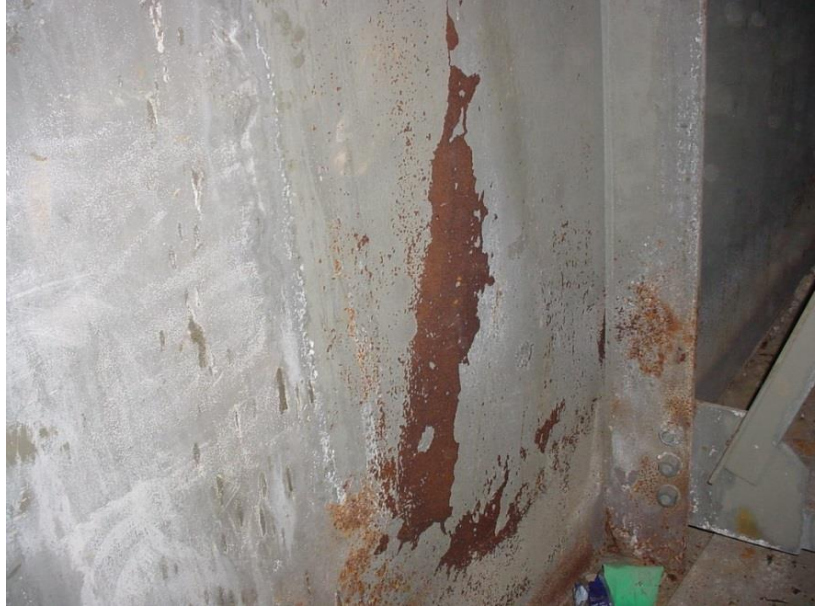
الشكل (١-٧) التآكل البسيط على طول عوارض السقف.
