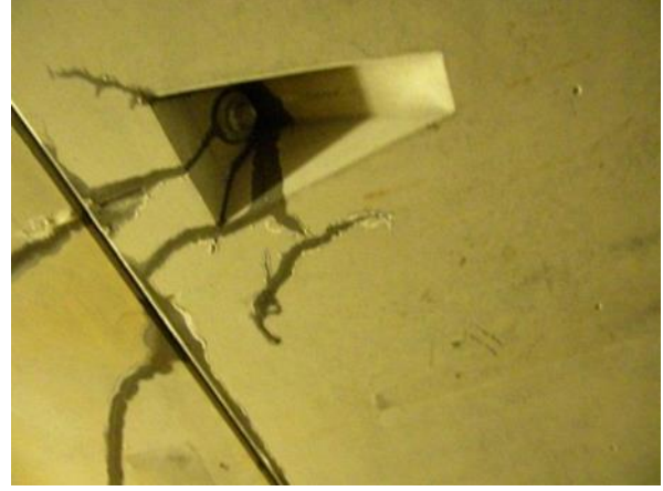
الشكل (٧-١١) شقوق الرطوبة في بطانة القطاعية بسبب تقنيات التركيب الخاطئة.
